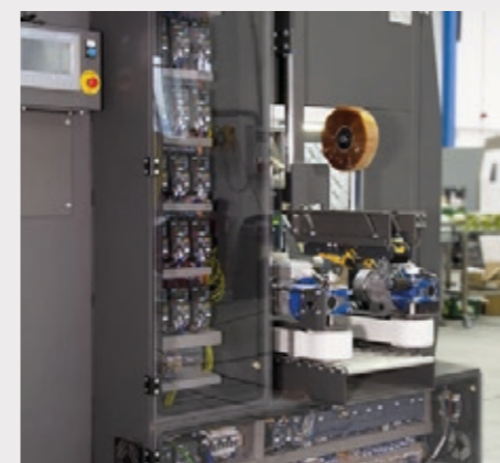
Quadro elettrico a vista per una diagnosi immediata.
