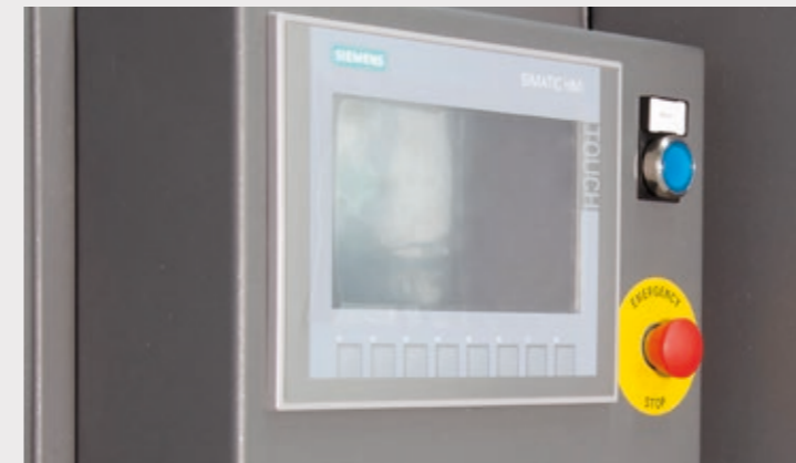
Pantalla táctil SIEMENS u OMRON, intuitiva y de fácil utilización para el operador.
