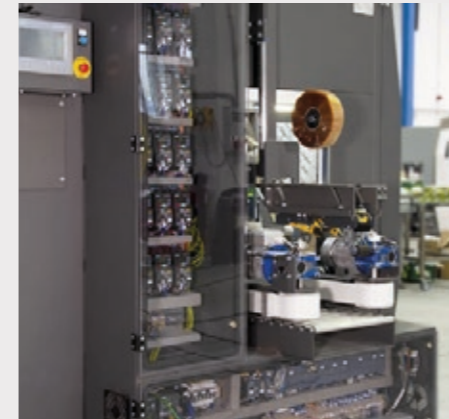
Cuadro eléctrico a la vista para un diagnóstico inmediato.
