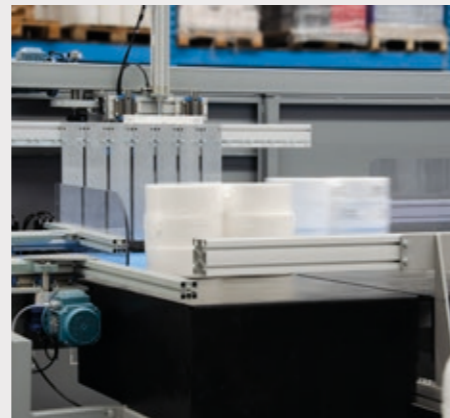
Systèmes d'alimentation équipés de poussoirs motorisés, pour dévier les produits qui arrivent dans des canaux différents vers le poste de palettisation.
