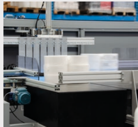
sistemas de alimentación equipados con empujadores motorizados para desviar los productos en entrada a canales diferentes hacia la estación de paletización.
